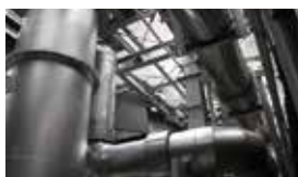
プラント配管
